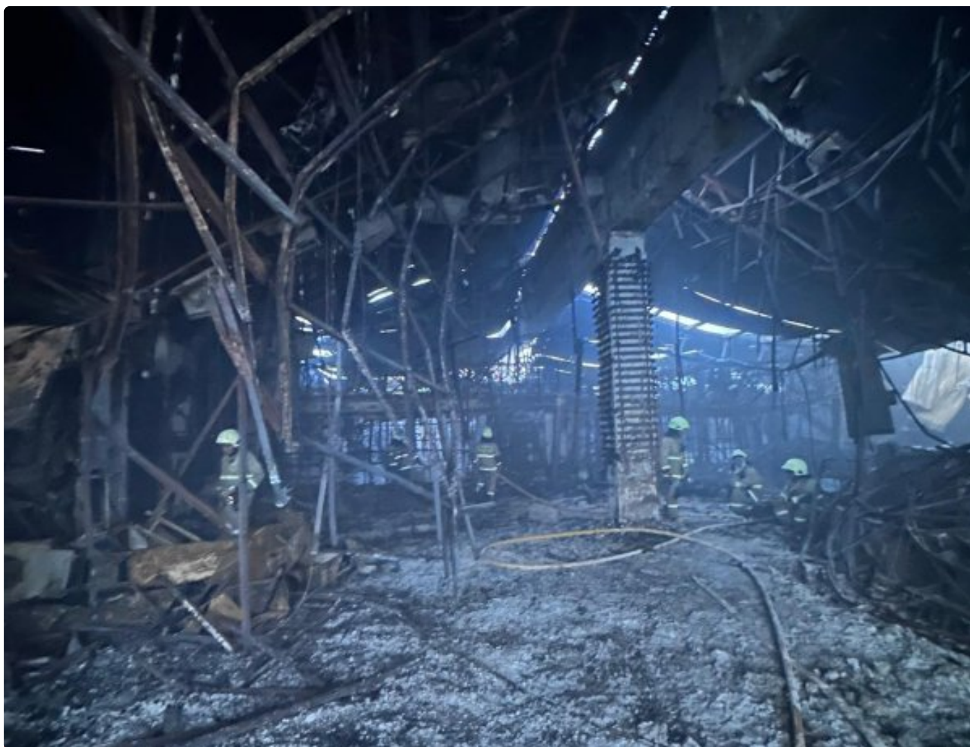
Glodok Plaza yang Hangus Terbakar
